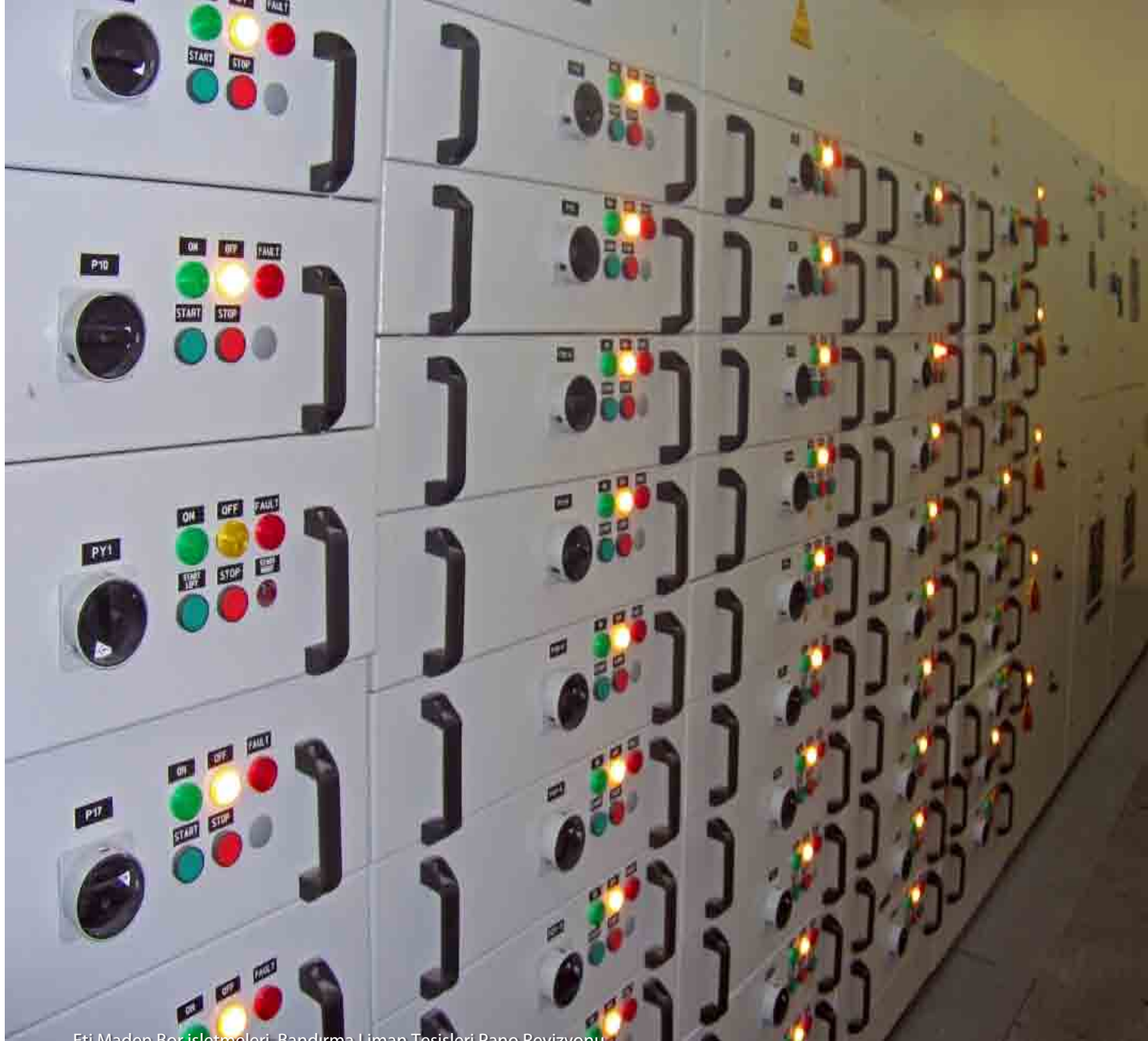
Eti Maden Bor İşletmeleri, Bandırma Liman Tesisleri Pano Revizyonu
