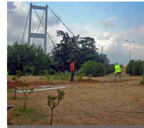
K.G.M. Boğaziçi Köprüsü İş Tanımı : Kamera Güvenlik Sistemi Kurulumu Görsel : Kamera Network Hattı Çekilmesi
